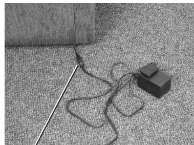
Connexion du transformateur
